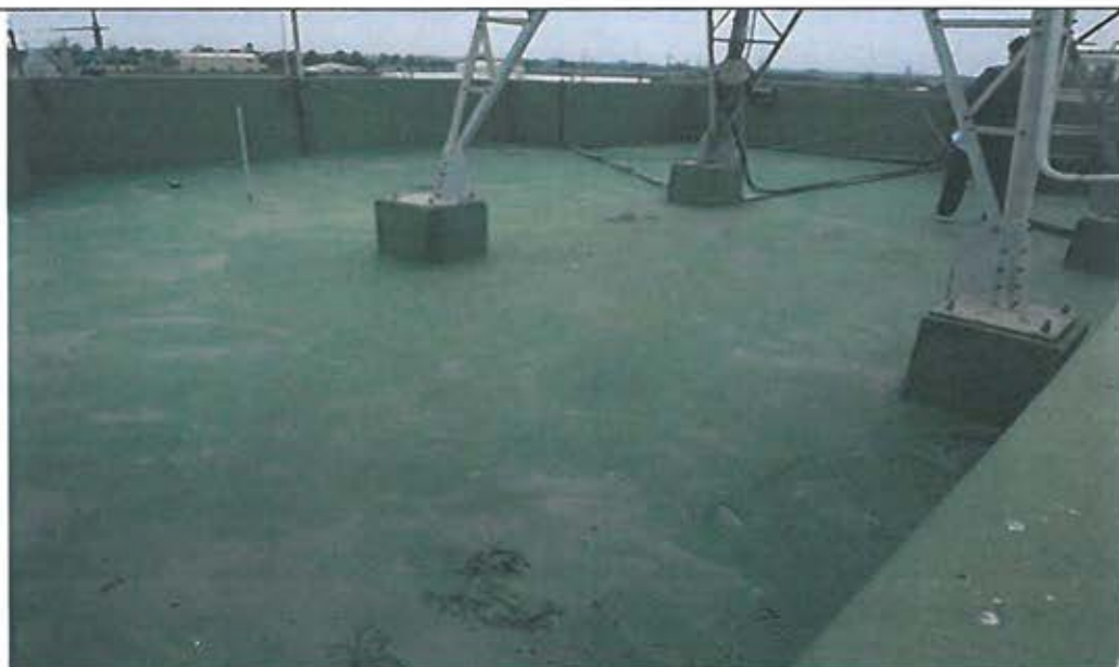
屋頂地面防水層老化 PU 施工前
