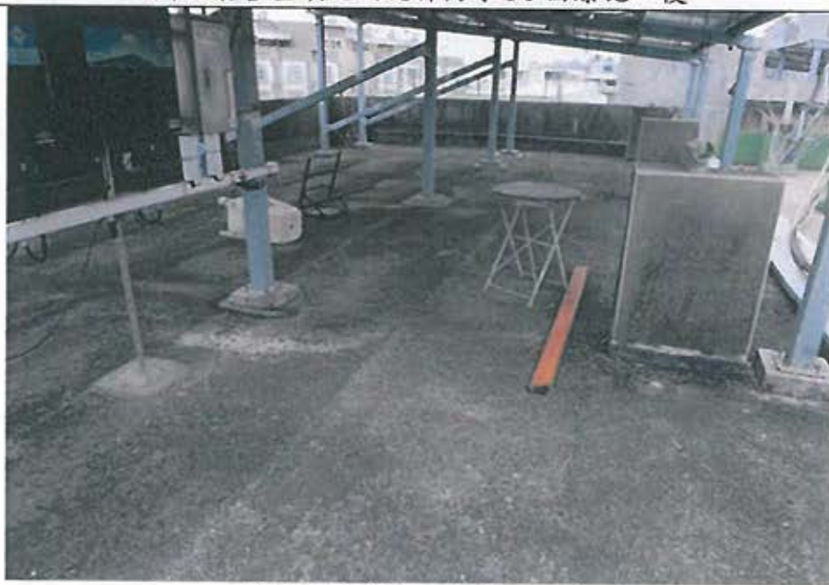
增建辦公廳舍防水 P 施工前
