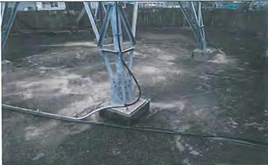
辦公廳舍屋頂防水 PU 老化施工前
